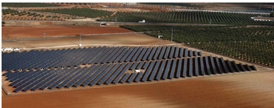
Solarpark „El Cura“ in Antequera/Andalusien.
