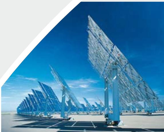
Solkraftwerke mit Nachführtechnik Quelle: ABB
